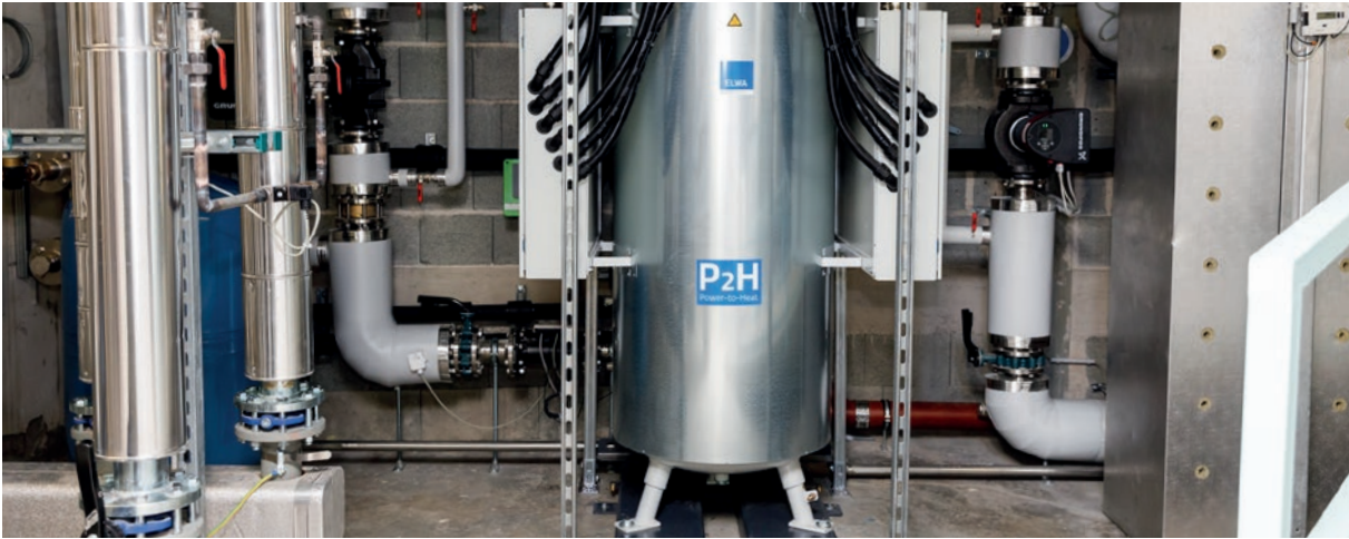
Power2Heat-Anlage im Hallenbad Amraser Straße
